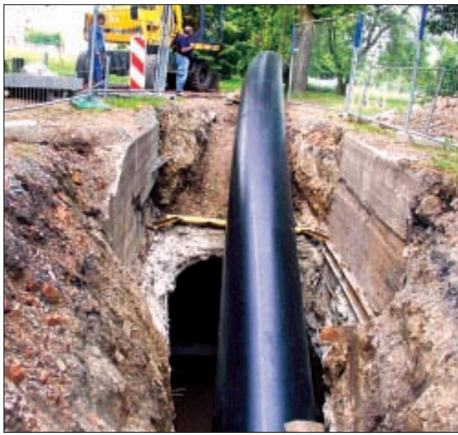
Künftig muss mehr Geld in die Sanierung des bestehenden Anwassertsystems fließen. Dazu gehört auch die Trennung der Bauläufe von den Abwasserkanälen wie hier am Gablenzbach. Foto: Archiv-ASR
