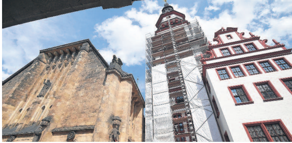
Vom Marktplatz aus konnten Passanten lange Zeit das Baugeschehen am Neuen Rathaus beobachten. Eine Dachsanierung einschließlich der Erneuerung des Blitzschutzes ist im Juni abgeschlossen worden. Foto: Andreas Seidel
