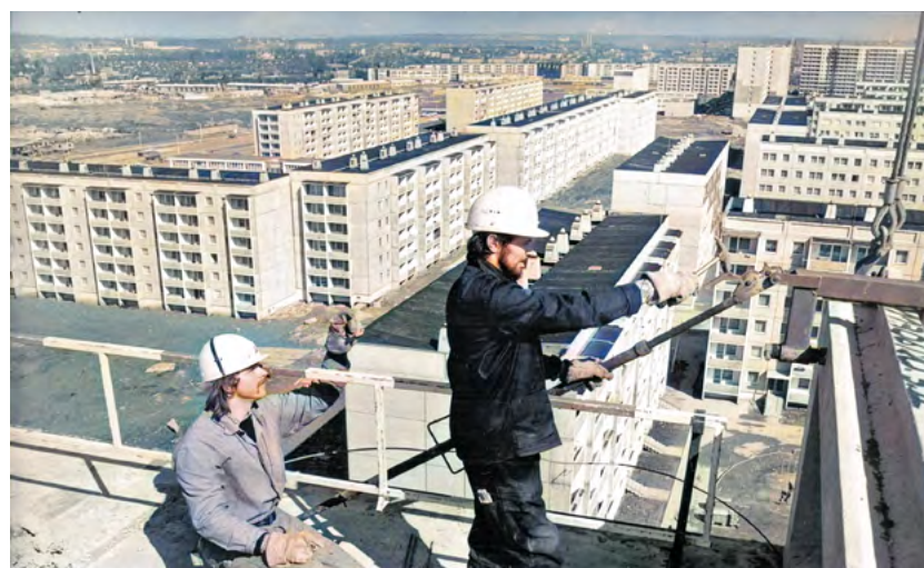
Bauarbeiter auf dem Dach eines Plattenbaus der Dr.-Salvador-Allende-Straße 156-160 im Jahr 1978. Foto: Leibniz-Institut für Raumbezogene Sozialforschung
