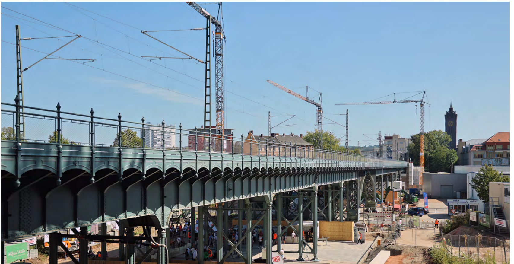
Das denkmalgeschützte Viadukt in Altchemnitz und der gesamte Chemnitzer Bahnbogen sind fertig saniert.
