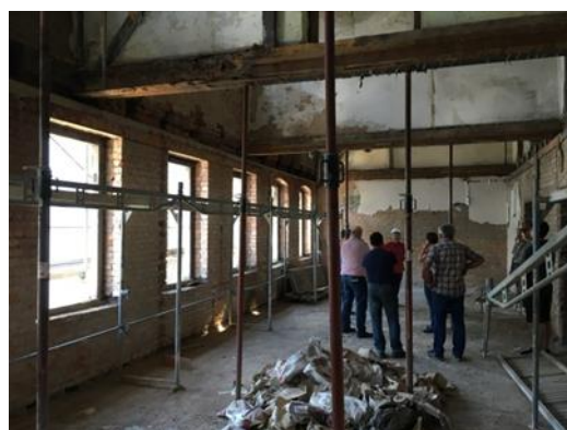
Begehung eines gründerzeitlichen Mietshauses auf dem Sonnenberg während Sicherheitsmaßnahmen, 2017 Quelle: Stadt Chemnitz
