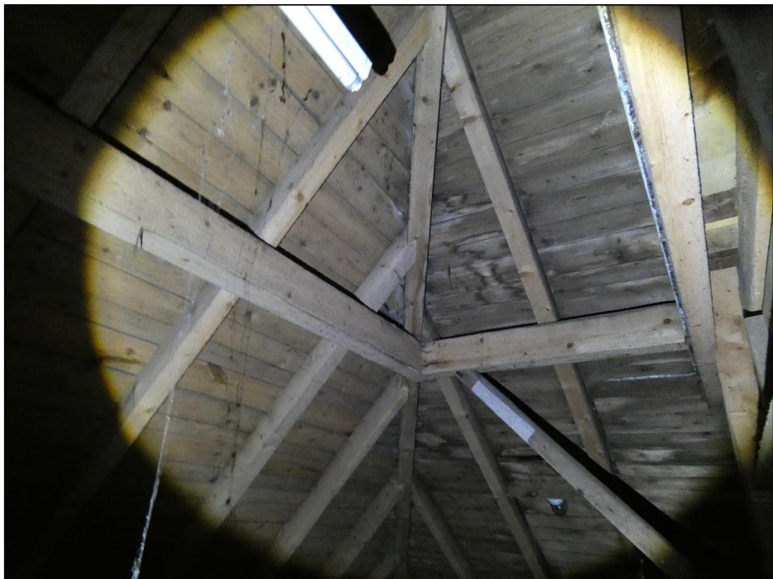
Abb. 6: Dunkle Ecken im Dachboden im südlichen Teil von BW3
