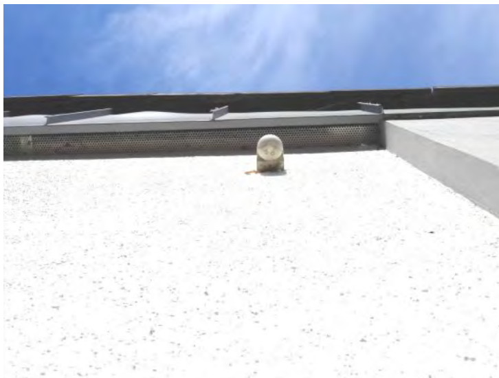
Foto 8, 9, 10: An Dachabschlüssen sowie zwischen Giebelverkleidung und Fassade sind sämtliche Spalten verschlossen. Auch zwischen Dachkante und Regenrinne sind keine besiedelbaren Zwischenräume vorhanden.
